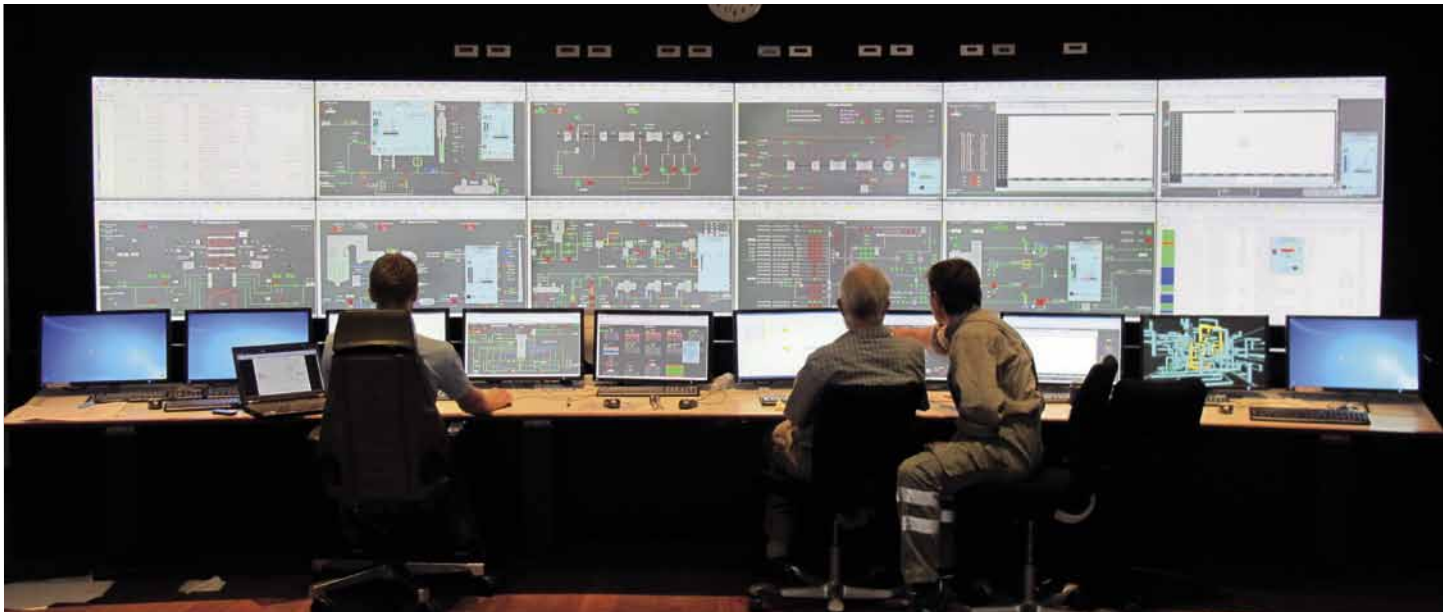
Den imponerende skærmvæg, der er installeret på den ene endevæg, er i brug 24/7 og består af 6x2 55" LED-skærme.
